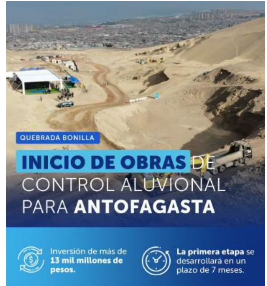
Obras de control aluvional en Quebrada Bonilla Región Antofagasta
