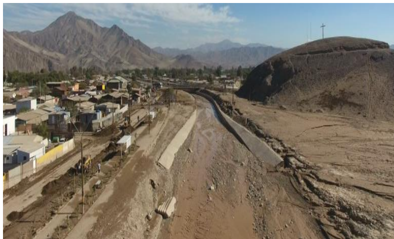
Ilustración 20. Inicio de la obra de encauzamiento canal de protección, se aprecia obra post evento 25M Fuente: SEIA, 2018
